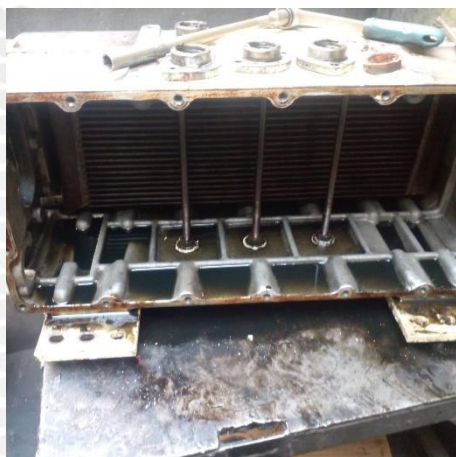
Intercooler con aceite generador de babor
