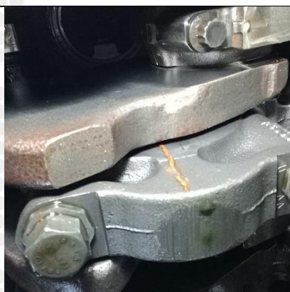
Perdida previa de agua por camisas generador estribor
